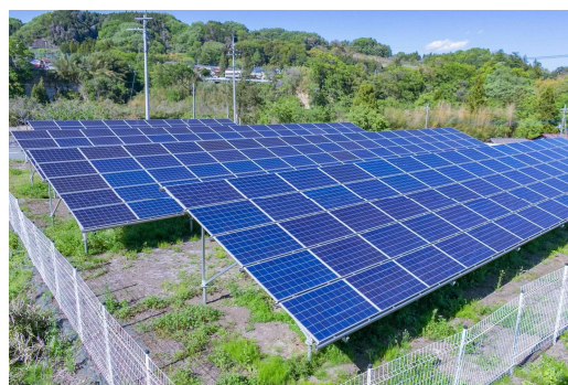
太陽光パネル
