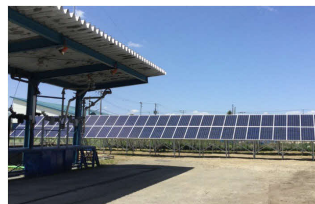
北日本石油 中標津太陽光発電所 52kW（約2,000㎡） https://www.kitanihon-oil.co.jp/news/1210/
