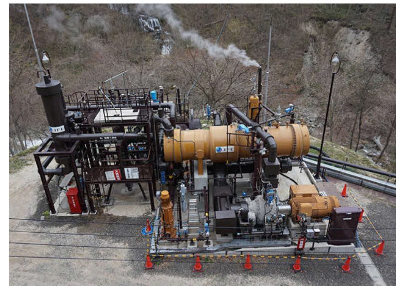
土湯温泉16号源泉バイナリー発電所（福島県福島市） https://www.renewable-ei.org/activities/column/20180507.html
